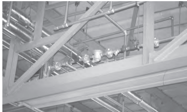
配管ラインスチームトラップ
