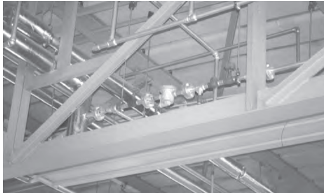
配管ラインスチームトラップ
